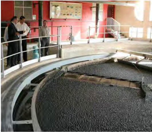
La station d'épuration de Saint-Palais-sur-Mer, associée à celle des Mathes, rejettent toutes les deux 4,5 millions de mètres cubes d'eau usée traitée par an.
