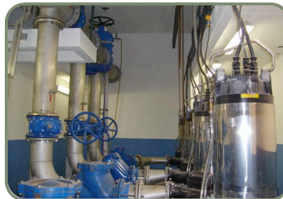
Postes de refoulement du « Rhâ » à Saint-Palais-sur-Mer.
