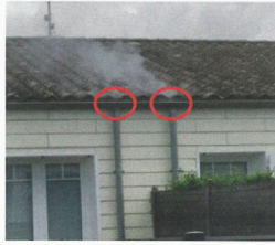
Exemple d'anomalie identifiée par un test à la fumée, avec cette gouttière raccordée au réseau d'eaux usées.
