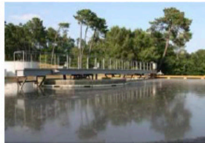
Une grande partie des eaux usées est traitée à la station d'épuration de Saint-Palais-sur-Mer. ARCHIVES ROMAN CHÉTEL
