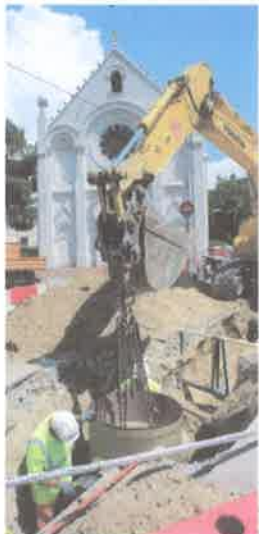
À Iroyen, les travaux de l'avenue de Paris sont interrompus pendant l'été.
