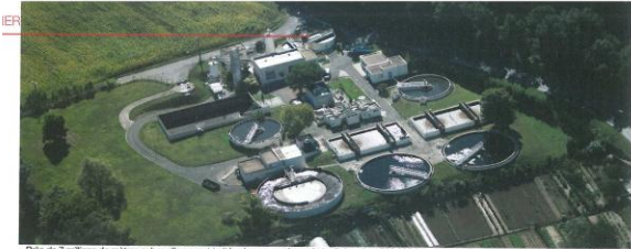
Plus de 7 millions de mètres cubes d'eau sont traités chaque année sur le territoire, dont 900 000 à la station d'épuration de Saint-Georges-de-Didonne.
