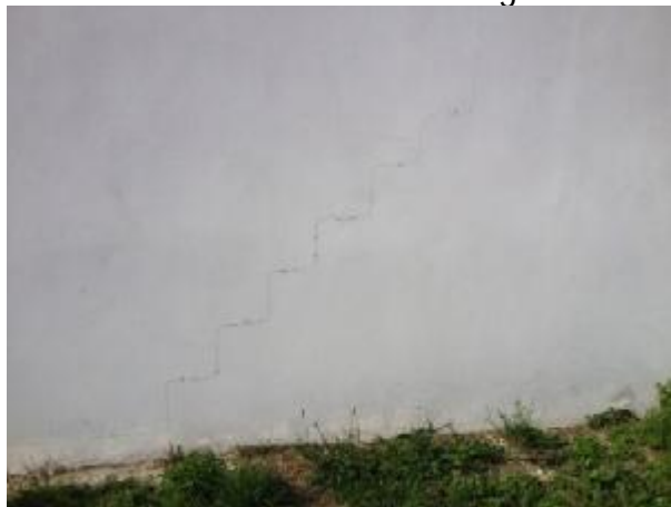
Fissure local traitement Bourgeoisie
