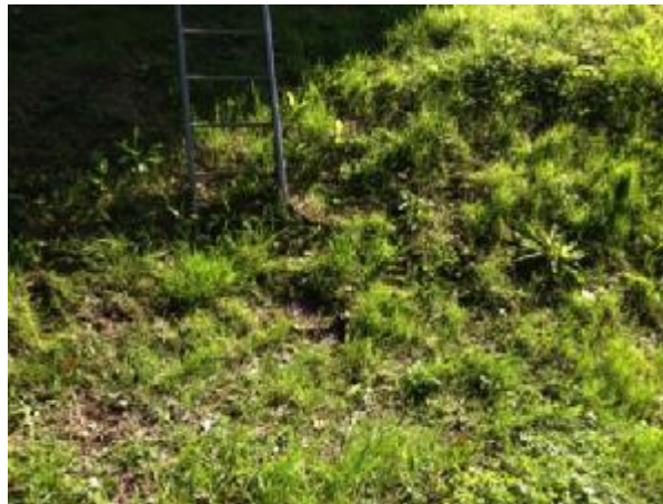
Humidité anormale au pied de la bâche de Belmont
