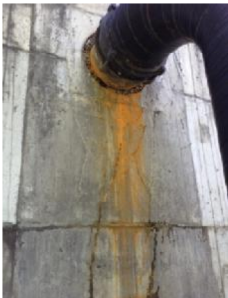
Fuite bâche de Belmont
