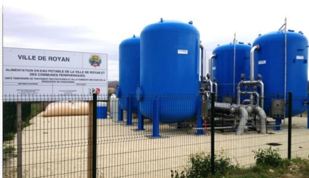
Station de traitement temporaire des eaux de Chauvignac
