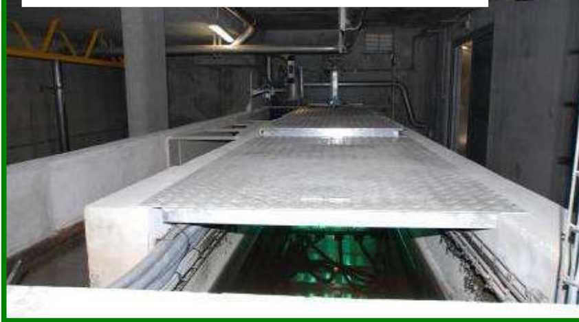
DESINFECTION AUX ULTRAVIOLETS des eaux traitées
